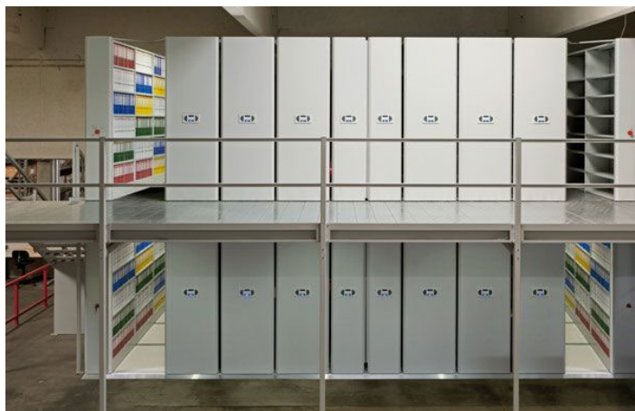
Kompaktarkiv kan även byggas i två våningar
